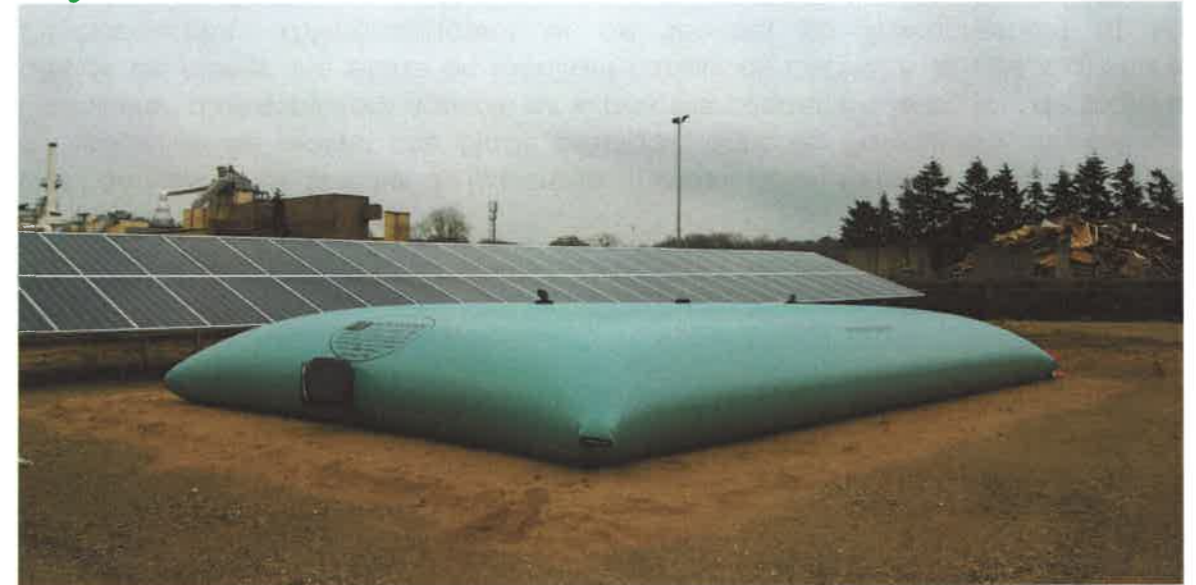
Figure 4 - Réserve incendie souple 60 m 3 (Source : SOG SOLAR)
