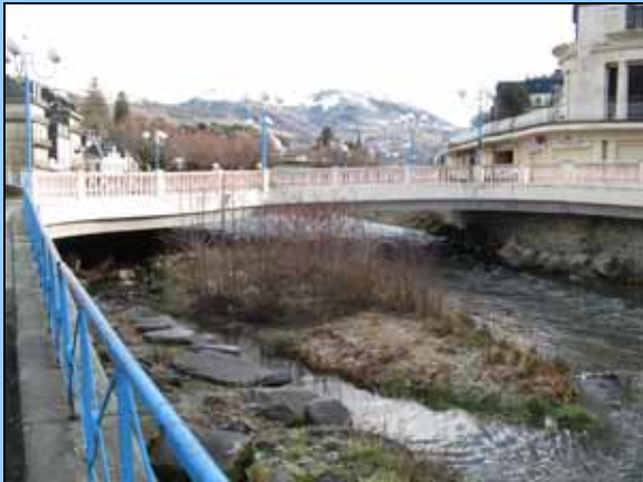
Photo 9 : section hydraulique diminuée par la présence d'un îlot en cour de végétalisation (photo BCEOM)
