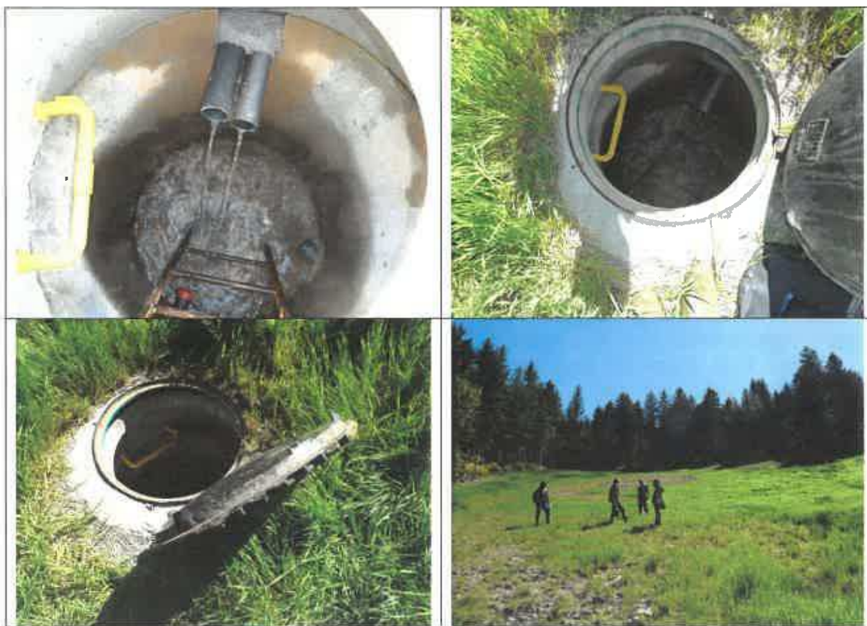
Centralisateur de Betonasse 2 et environnement
