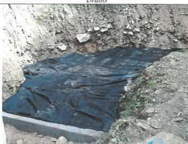
Géotextile de recouvrement
