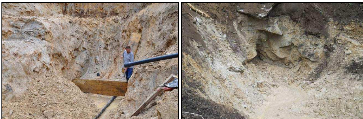
Captage de « Bétonasse n°2 » : vues sur les deux émergences captées dans les altérites du socle
