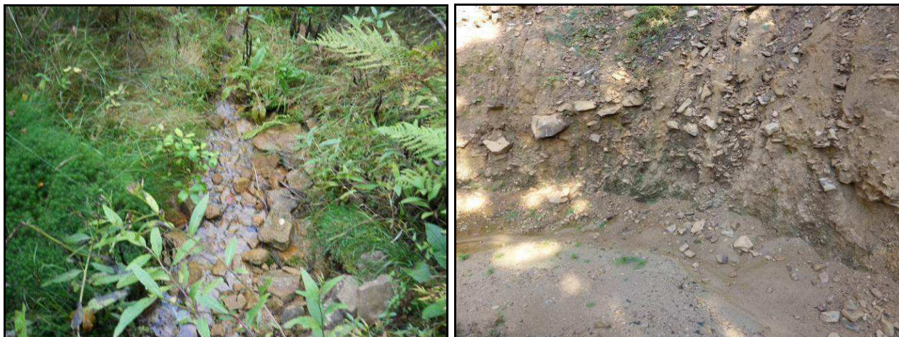
Captage de « La Sablière » : vue sur l'émergence de la source et le front de captage à l'automne 2017
