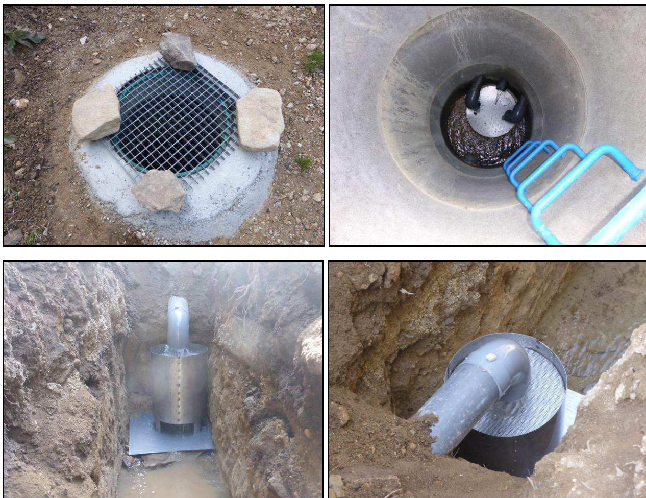
Aménagement simple sur le captage de « La Sablière » pour l'essai de dégazage du radon à l'émergence
