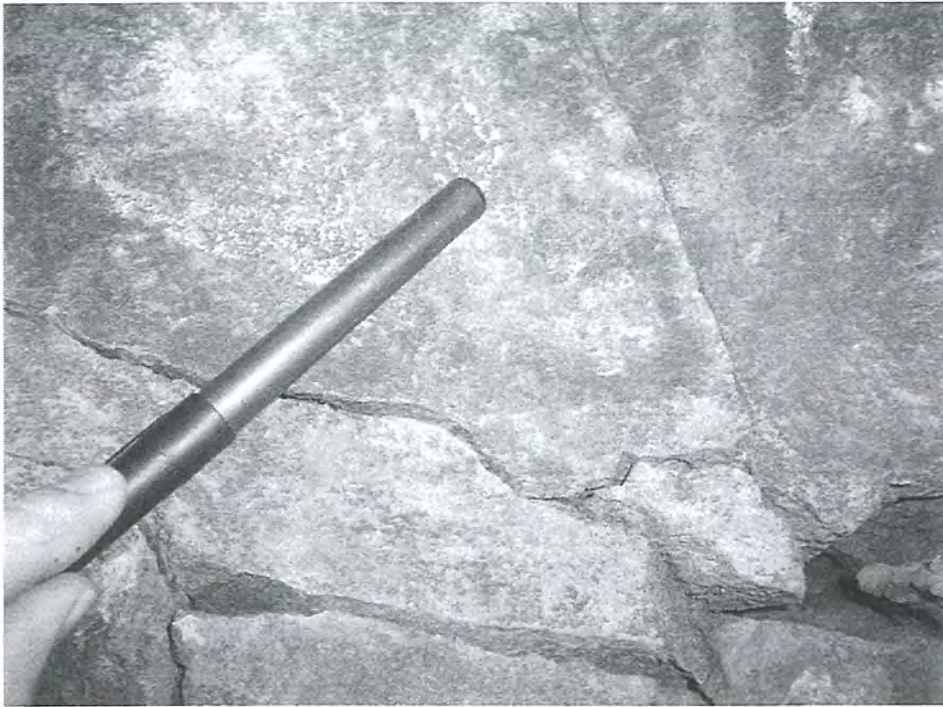
Coulée des Grosliers : fissuration
