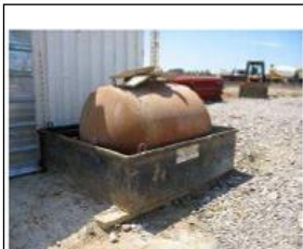
Bac de protection pour cuve fuel
