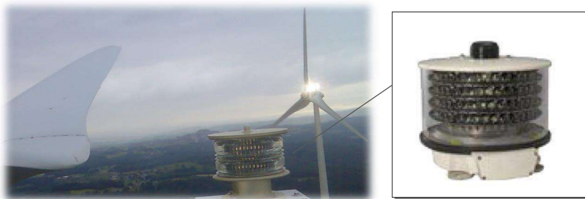
Figure 35 : Balisage d'une éolienne
