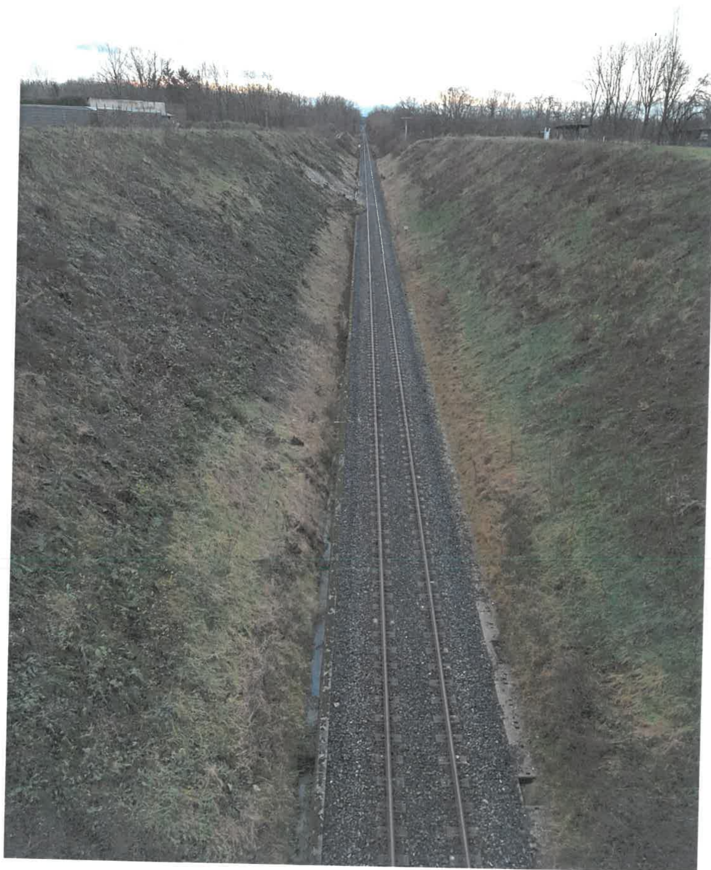
P2 – Photographie glissement de terrain
