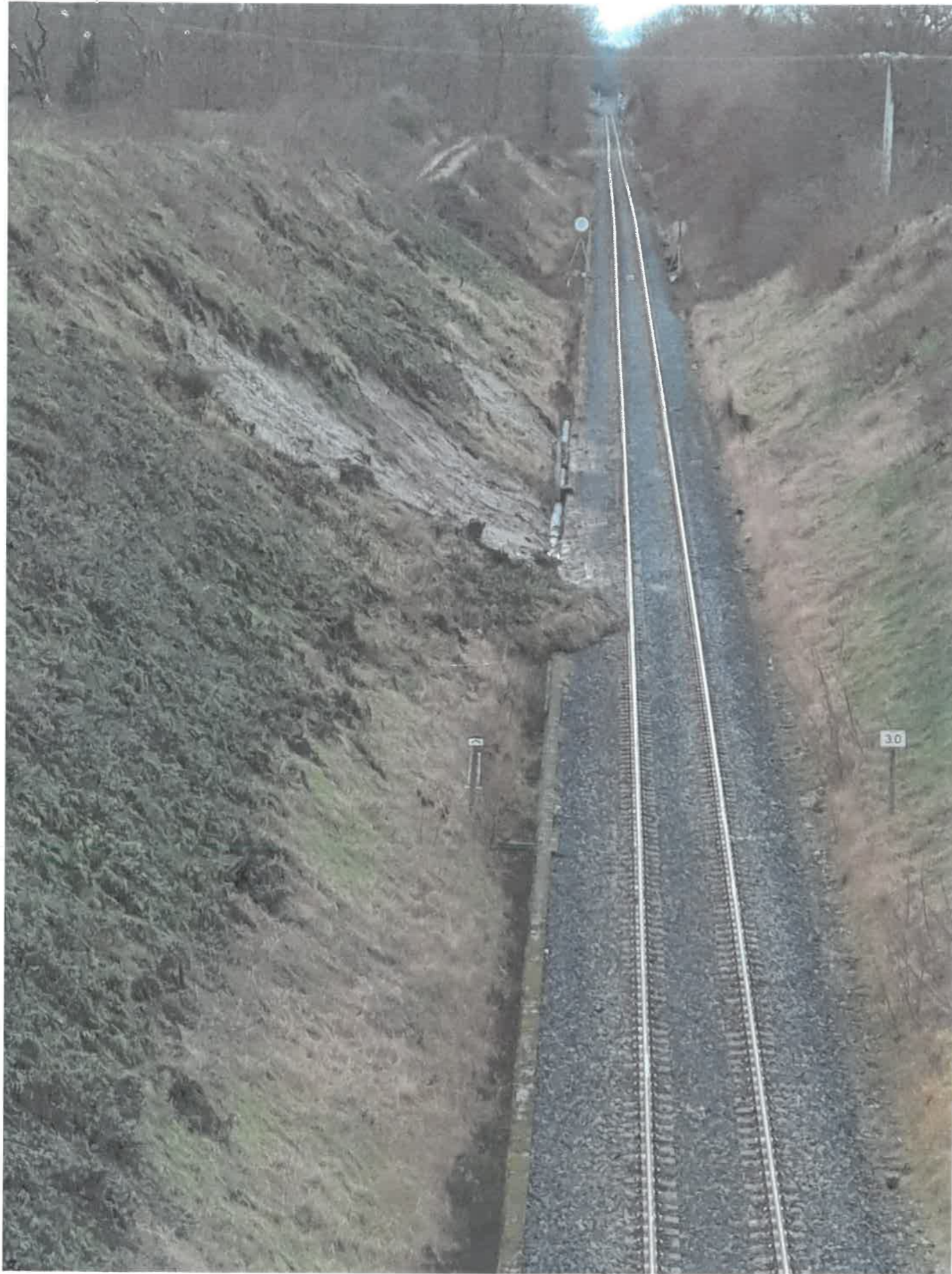
P3 – Photographie glissement de terrain
