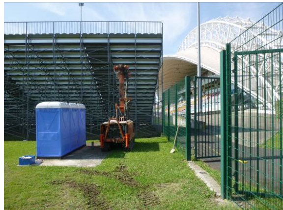
Figure 4 : Vue de la réalisation du sondage ST1 sur l'arrière de la tribune modulaire Nord
