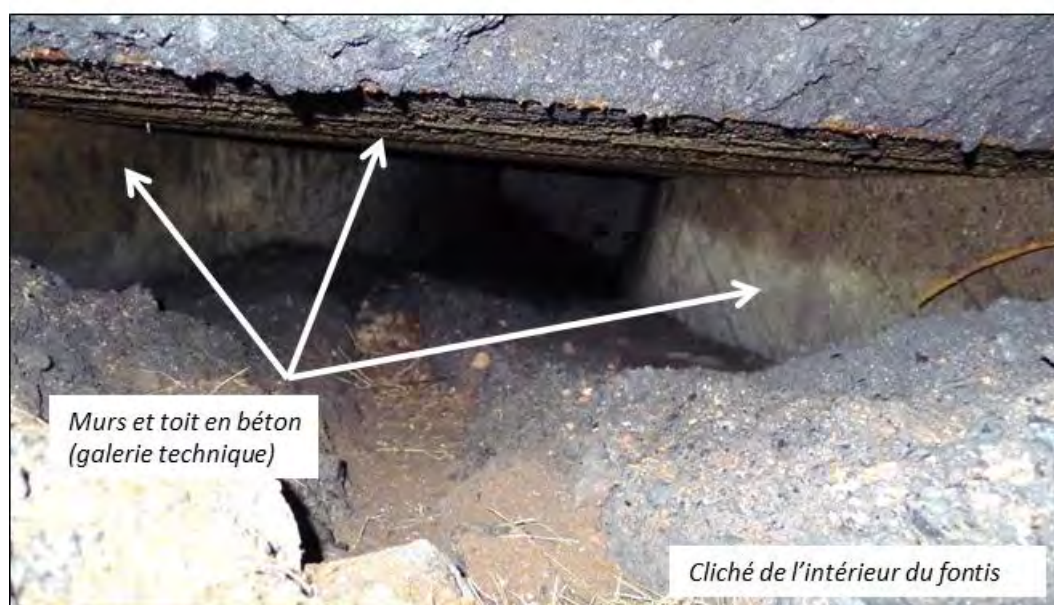
Figure 18a : Fontis sur galerie technique liée au puits Saint Alexandre
