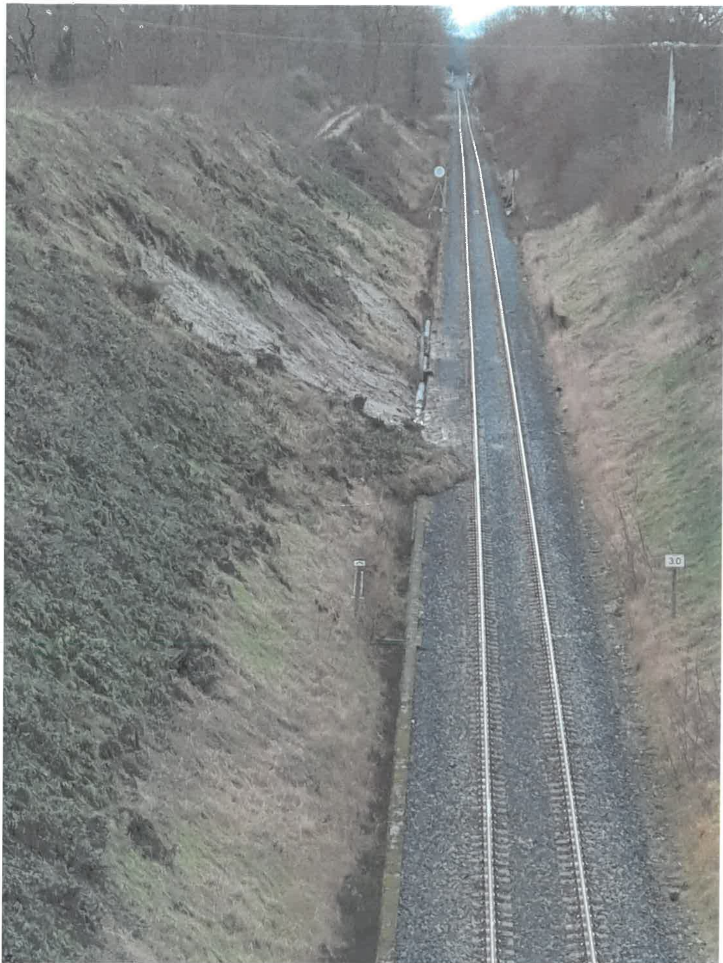
P3 – Photographie glissement de terrain
