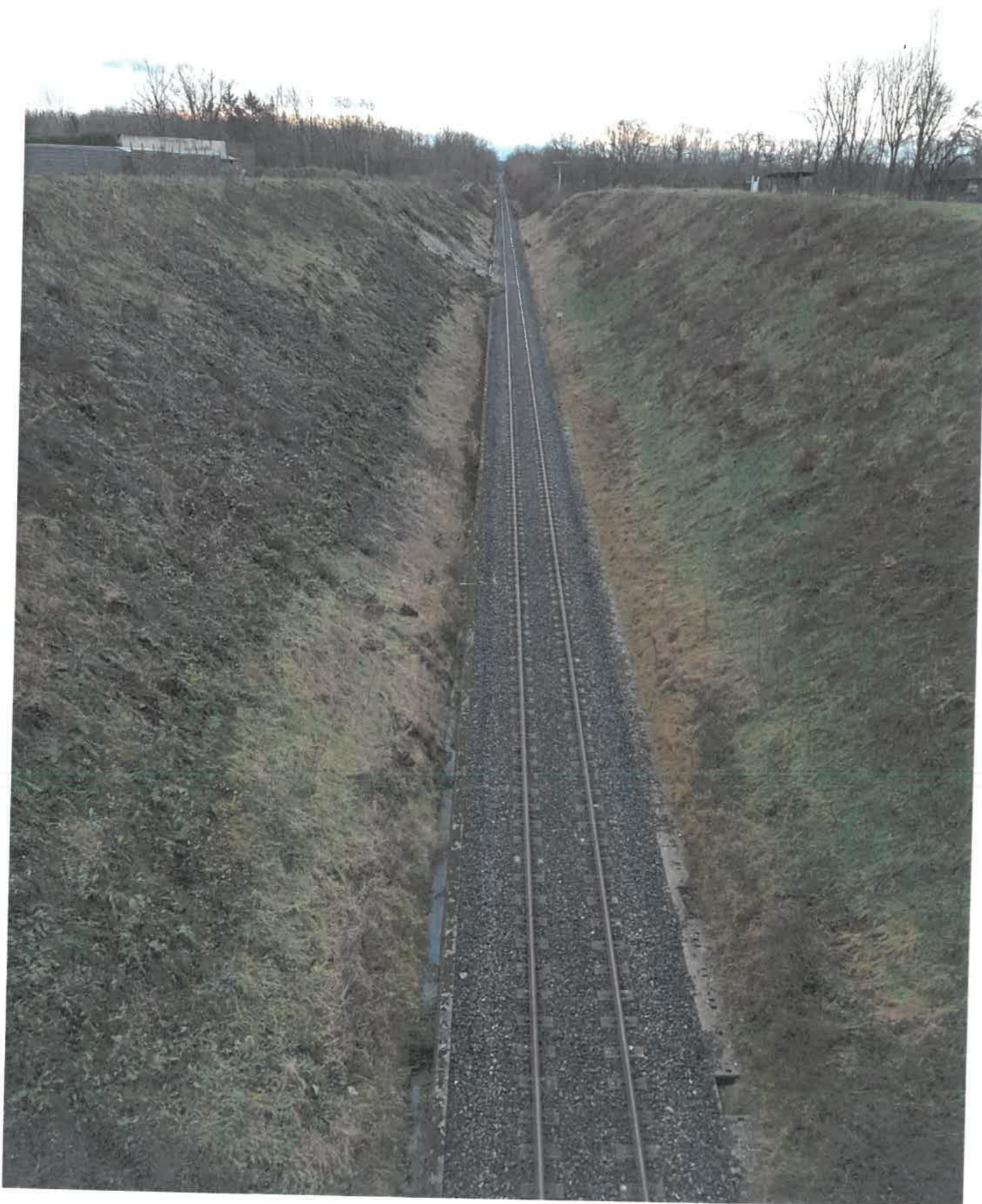
P2 – Photographie glissement de terrain
