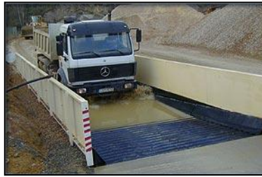
Aire de lavage des roues
