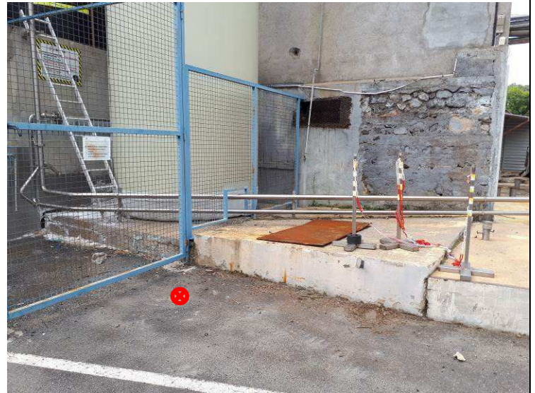
Photo 19 : ancien transformateur électrique
