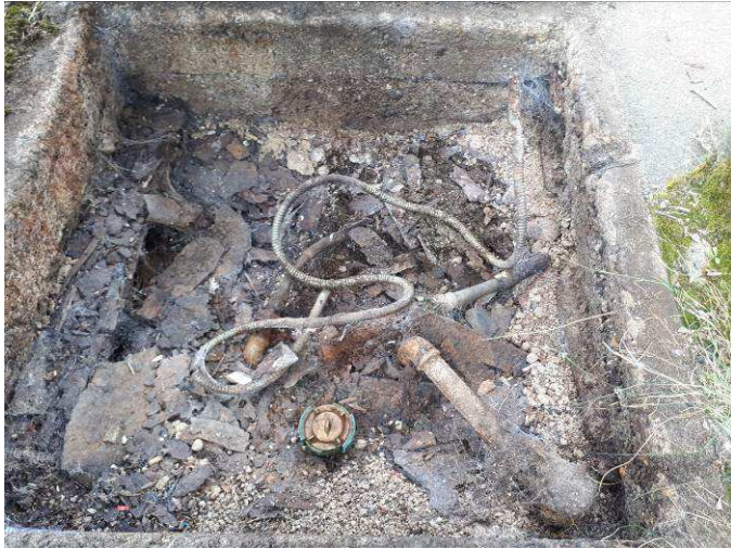
Photo 20 : regard de l' ancienne cuve de fioul
