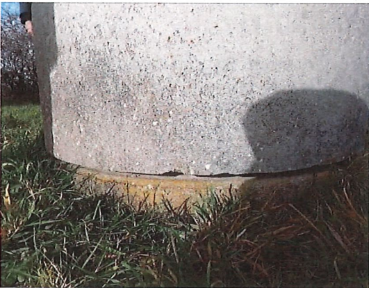
Photos n°5 : Exemple de défaut d'étanchéité au niveau du regard abritant la tête du forage à
