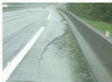
Photo 1 : Accumulation d'eau au PR 22+200
