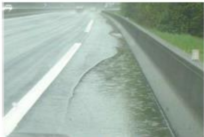
Photo 1 : Accumulation d'eau au PR 22+200
