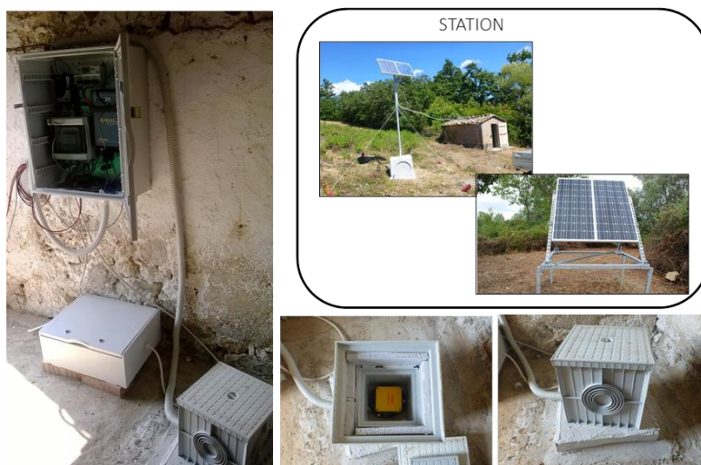
Figure 5 : Exemple d'installation d'un sismomètre sur le site de Castelnuovo (Italie) Source : Graziella Green Power
