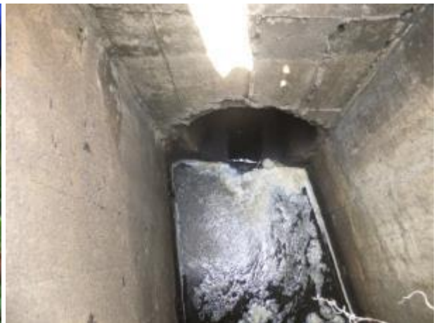
Figure 8 : Regard de visite de la conduite d'alimentation
