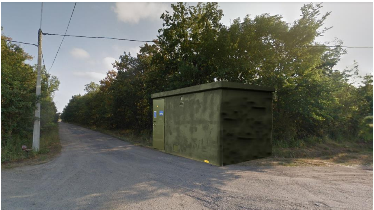
Figure 14 : poste de livraison le long de la RD332
