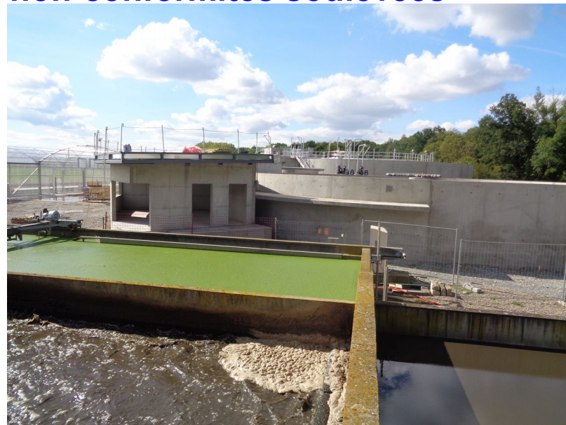
Travaux sur la station d'épuration du syndicat de Morge et Chambaron au premier plan l'ancienne station, au second la nouvelle – mars 2017
