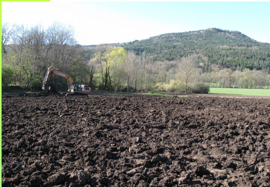
Remblais d'une zone humide St-Nectaire, village de Saillant – Photo DDT63-2017
