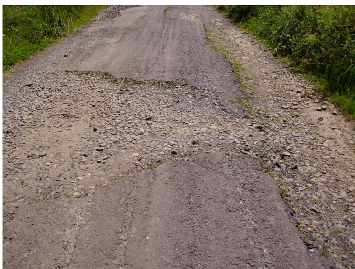
Piste au niveau du point A de la carte n°4 (zone nettement dégradée, à l'endroit où le fossé n'existe pas)
