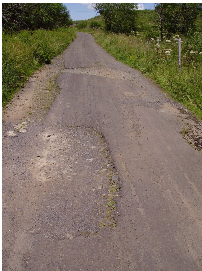
Un autre secteur dégradé
