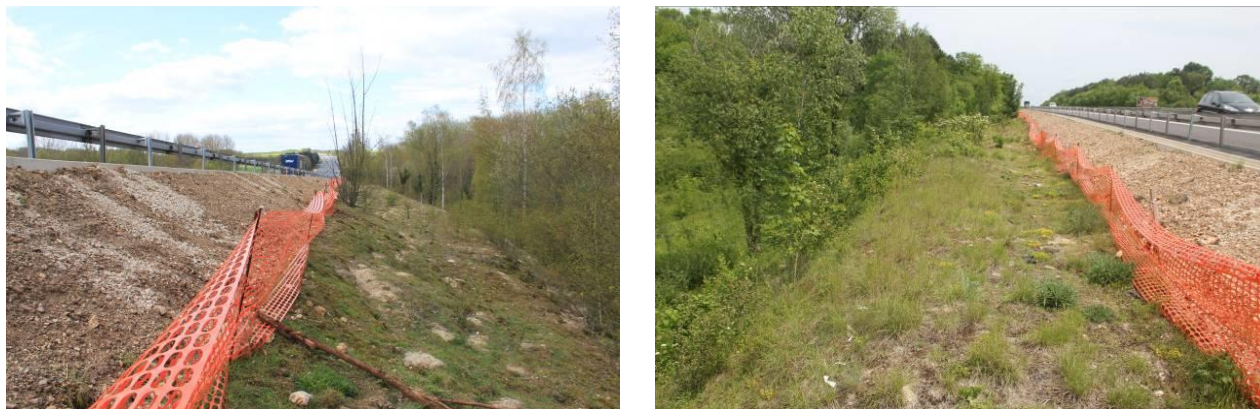
Mise en défens à l'aide de filet de protection sur un chantier autoroutier (A11, Cofiroute)
