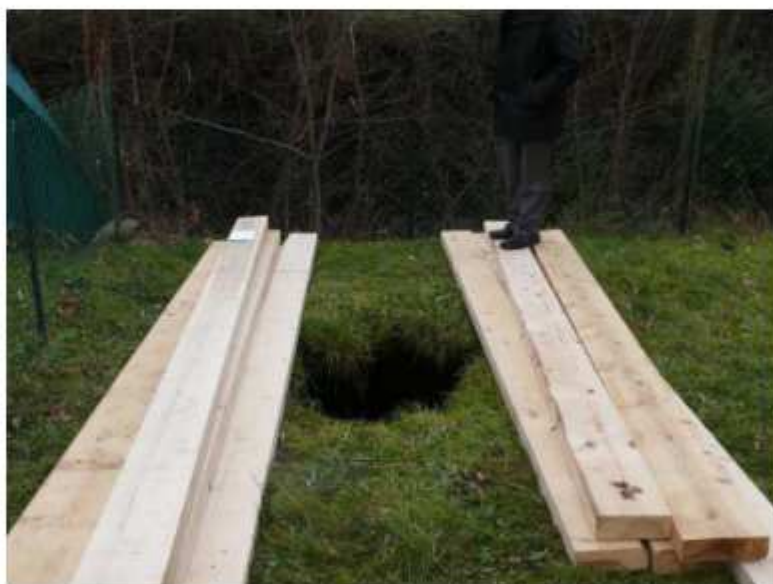
Photo 5 : Fontis de Sainte-Florine (Source : GEODERIS, 2008)
