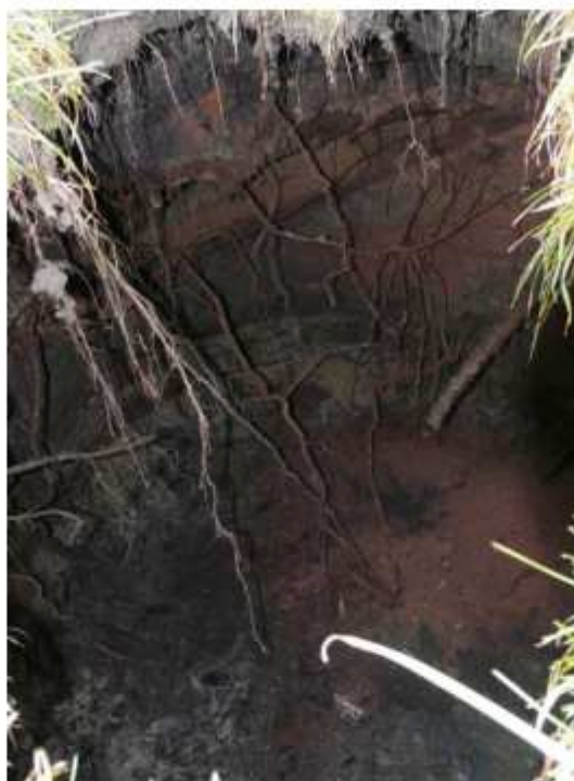
Photo 6 : Intérieur du fontis (Source : GEODERIS, 2008)
