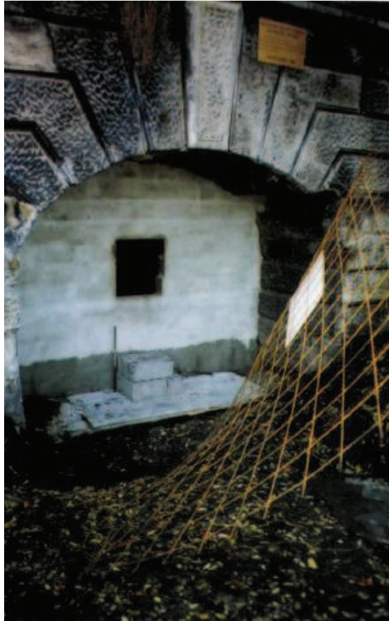
Photo 63 : Mise en place d'un mur étanche et d'un tuyau PVC à l'entrée du tunnel du puits des Graves
