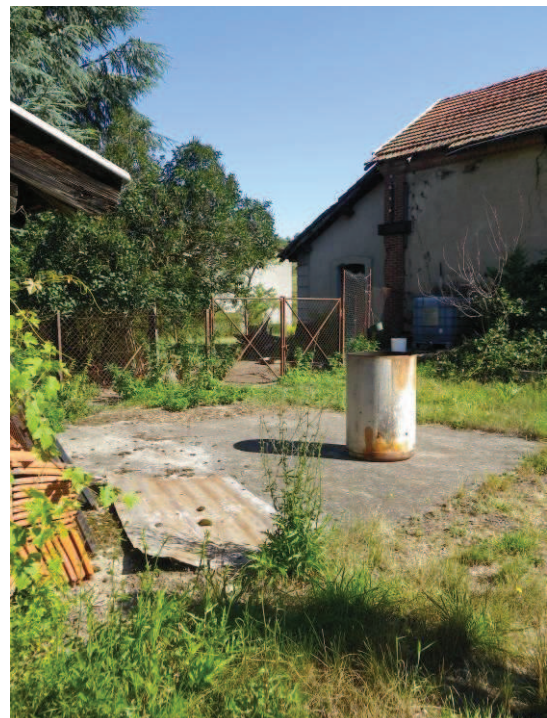
Photo 43 : Dalle à l'plomb du puits Morny (P103) - Barthes
