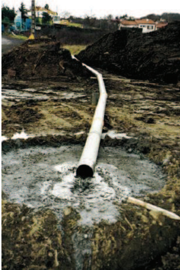
Photo 81 : Embouage du tunnel de Fondary (vue extérieure)
