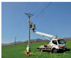
Déploiement du Très haut Débit dans la Loire © SIEL 42
