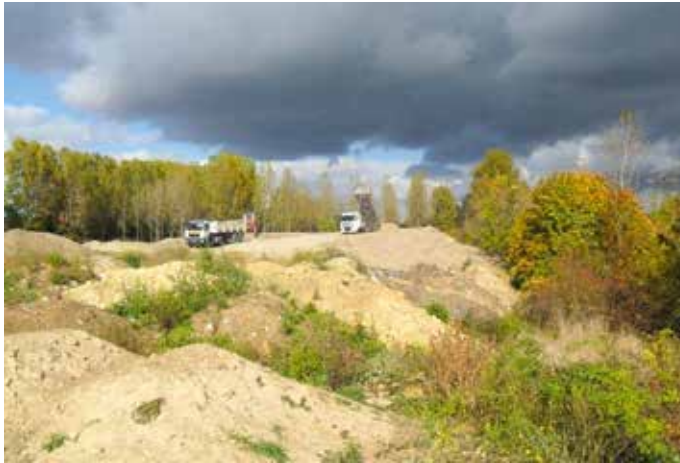
Remblai illégal en zone inondable de l'Allier
