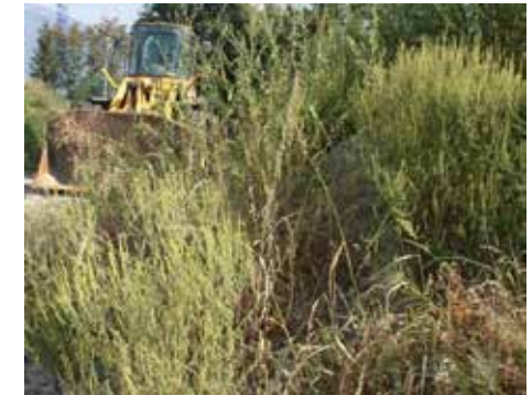
Remblai avec de l'ambrosie
